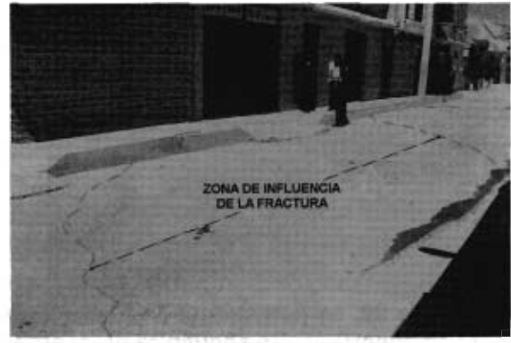
La foto 27 se aprecia de manera general la zona de influencia de dicha fractura. Nótese que la finca en cuestión se encuentra sobre la traza de la fractura.
