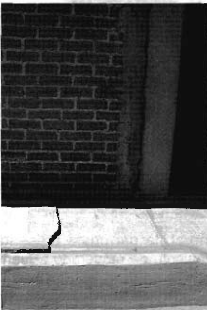
La fotografía 26 muestra un detalle del desplazamiento vertical que sufrió la construcción
