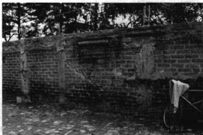
Foto 41. Muro en una de las propiedades de La Candelaria Tlapala, el cual resultó afectado por éste fenómeno de fracturamiento desde hace unos 6 años a la fecha
