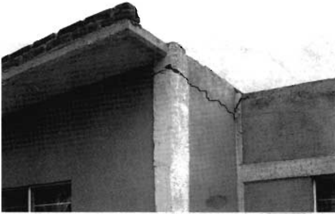
Foto 4.- Fisuramiento en pared de la casa, ubicada en el Callejón de Venustiano Carranza S/N
