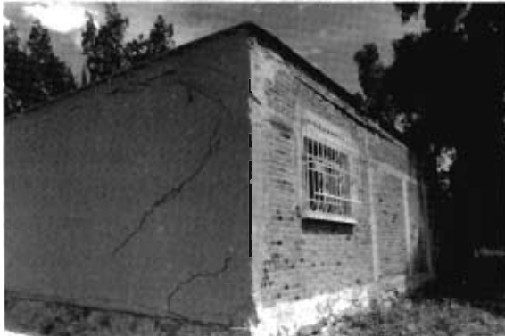
Foto 14. La imagen muestra los daños en muros y losa de una de las propiedades localizada en la en la Cuarta Cerrada de González Ortega
