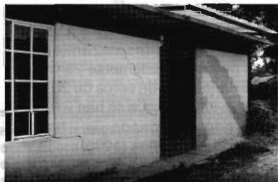
Foto 19. La foto muestra la serie de fisuras presentes en los muros de una construcción, ubicada en la Cerrada de Isidro González
