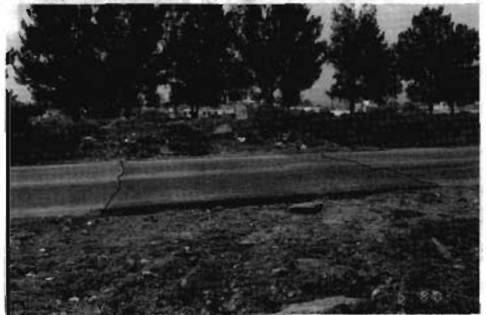
Foto 40. Tramo carretero que va de Chalco a Miraflores, el cual resultó afectado y reparado de inmediato. En éste punto la afectación alcanzó casi los 15 metros de ancho
