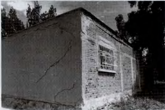
Foto 14. La imagen muestra los daños en muros y losa de una de las propiedades localizada en la Cuarta Cerrada de González Ortega
