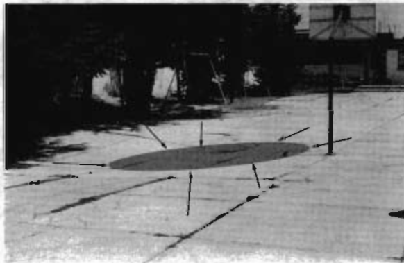
Foto 23. Piso del patio de la escuela, el cual presenta cierto grado de hundimiento, apreciándose claramente entre el columpio y el poste de la cancha de básquetbol
