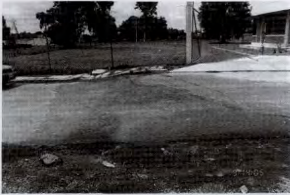
Foto 13. Obsérvese la afectación del pavimento y banqueta, producto del movimiento horizontal de aproximadamente 25 cm y un salto de la fractura de cerca de 20 cm en la calle Lucas Domínguez
