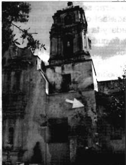
Foto 32. Fractura que afecta el lado sur de la nave principal, campanario y muro de colindancia con el ex-convento
