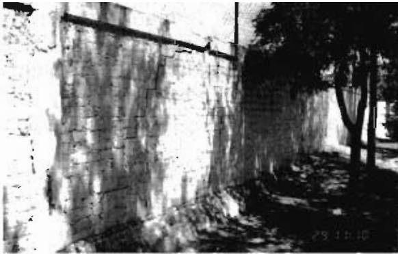
Foto 24. Sector poniente de la barda perimetral del plantel, nótese los efectos causados por la subsidencia del terreno, debido quizás a la presencia de una fractura en el terreno
