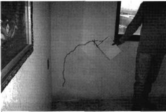
La foto 25 muestra los daños que presentan los muros de la finca ubicada en la Privada 10 de Mayo
